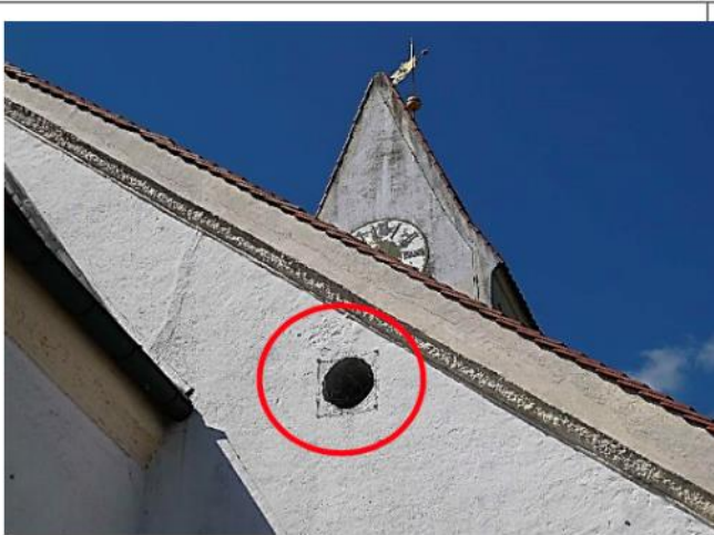
Vergitterte Einflugöffnung in den Dachboden fledermausfreundlich gestalten (vgl. Merkblatt Abb. 1 links oder 2 rechts)
