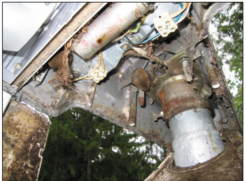
(Foto: Franz Schäffler; links oben der Leuchtkörper (angeschnitten), rechts der Mast)
