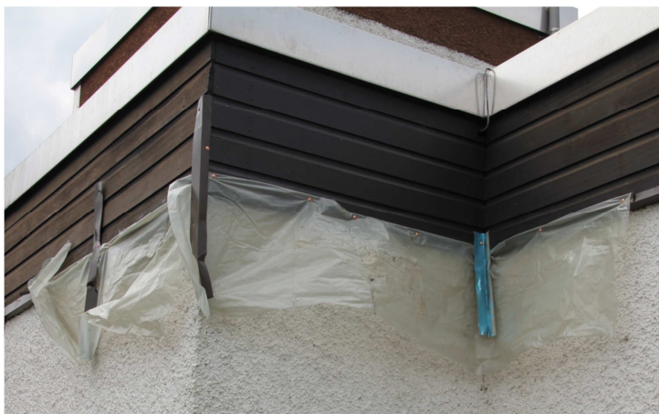
Abb. 6: Zu leichte Folie, die vom Wind angehoben wird. Sie muss durch Latten oder Bleche stabilisiert werden. Links im Bild reicht die Stabilisierung noch nicht aus (Bild A. Zahn).
